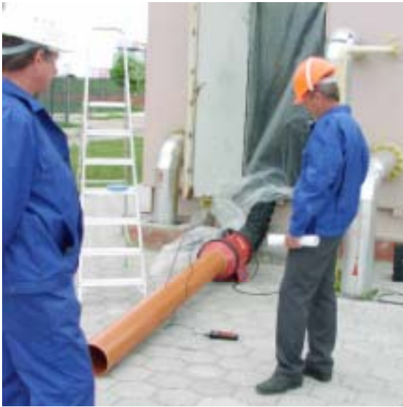
Foto 9: Volumenmessung an einer Brenngasversorgung in Kursk, Mai 2003.
